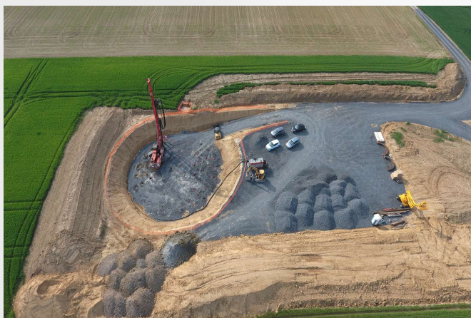
WINDMOLENPARK LA CHAUSSÉE BRUNEHAUT
